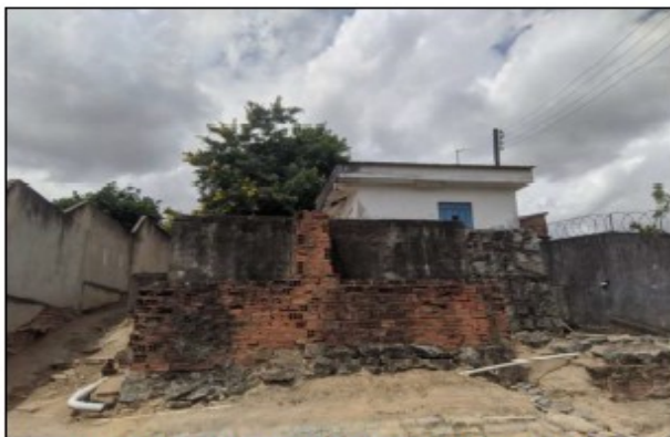
Figura 11 – Vista da EEAT Orobó, em más condições de conservação.
