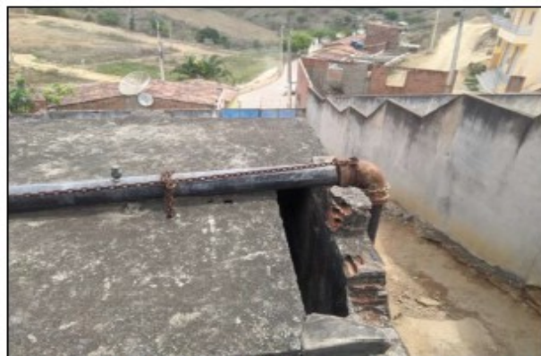
Figura 10 – Tubulação de chegada de água da EEAT Orobó, em más condições de conservação.
