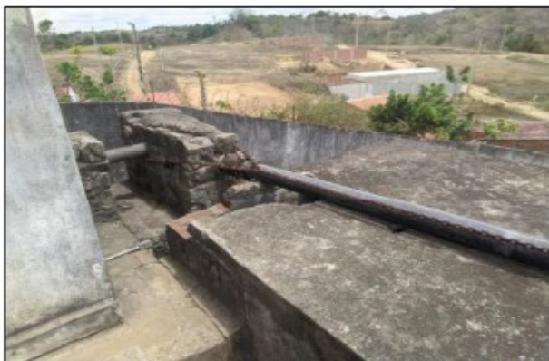
Figura 9 – Tubulação de chegada de água da EEAT Orobó.
