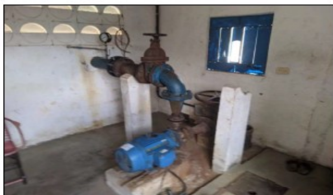
Figura 8 – Conjunto moto-bomba da EEAT Orobó.
